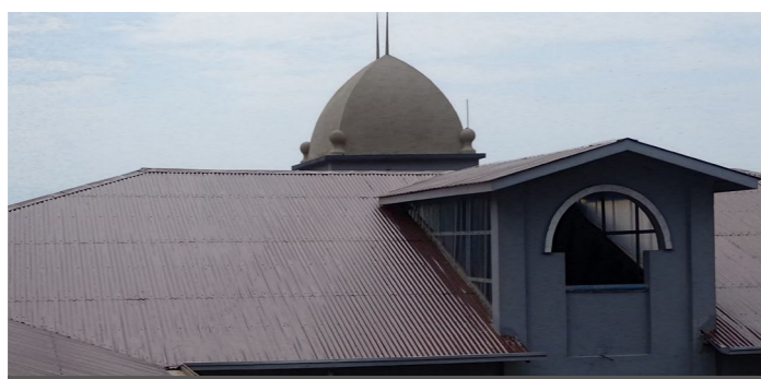
La toiture du CRH en RDC où seront installés les panneaux solaires
